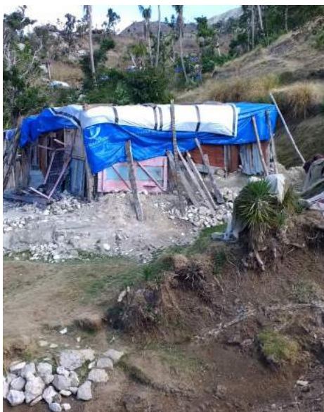
Une maison détruite aux Côteaux, février 2017
