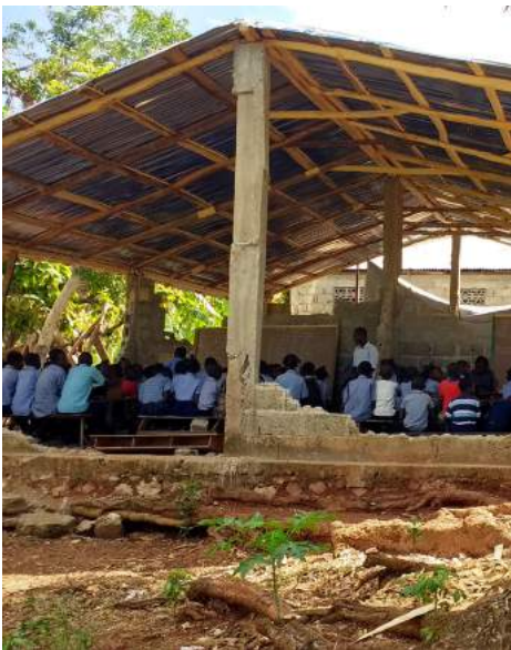
Ecole détruite à Durocher, Anse d’Hainault, février 2017
