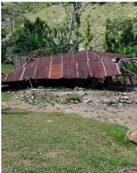
Une maison détruite à Boucan, Chambellan, février 2017
